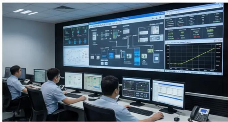
Hệ thống giám sát SCADA
