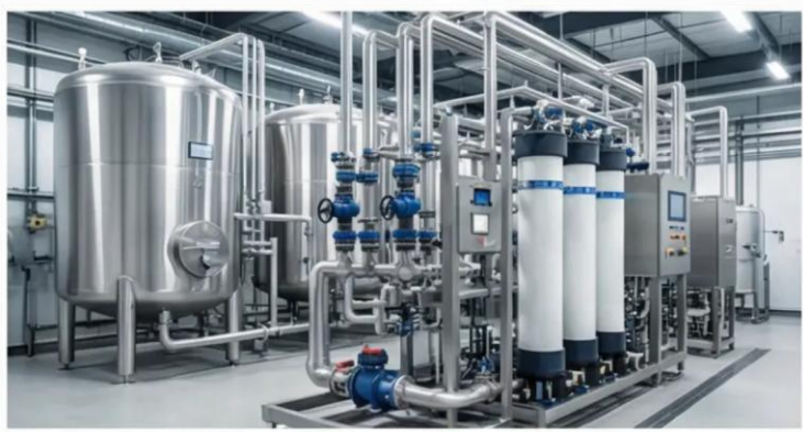
Hệ thống xử lý nước công nghiệp
