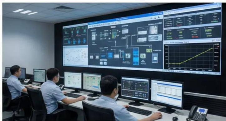
Hệ thống giám sát SCADA
